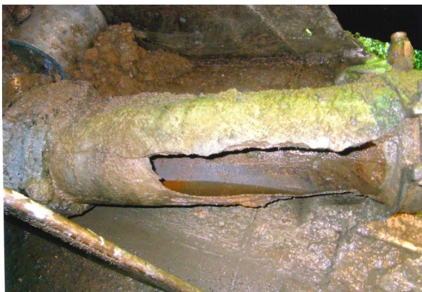
図表 3-16 漏水した管路
