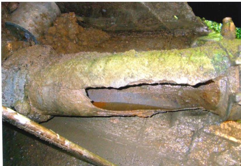
図表 3-1 6 漏水した管路
