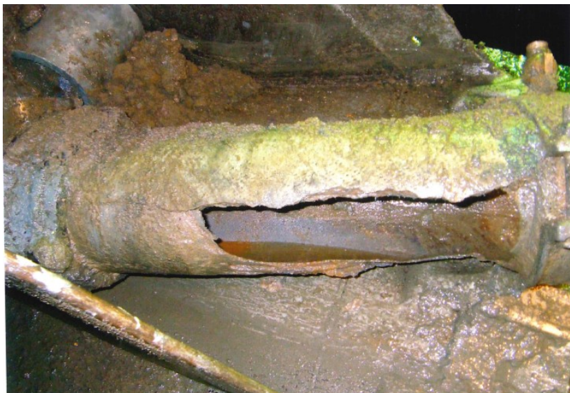
図表 3-16 漏水した管路
